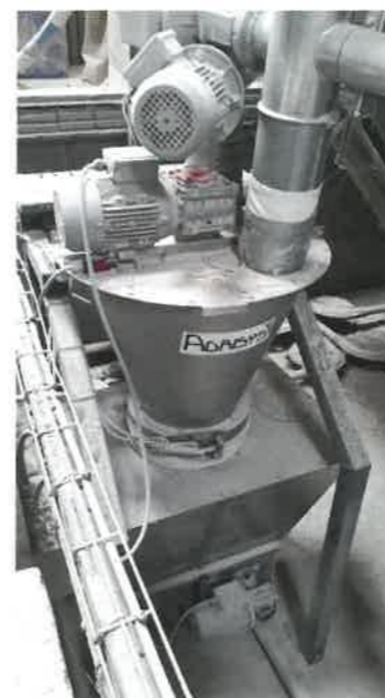
Figur 2. Anlæg med fodring på enkelt foderautomat niveau. Foto er af portionsblander placeret i foderladen. Aktuelle vægt afvejer portioner af 15 kg foder, som efterfølgende fremføres til enkelt stier.
